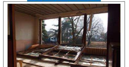
Orientée nord sud, l'école comptait 68 fenêtres emblématiques. Les remplacer aura également un coût.
